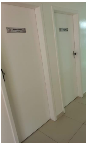
Imagem 12 – Portas sem identificação em braile.
