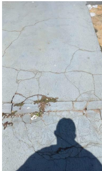
Imagem 02 – Rampa de acesso principal danificada e sem direcionamento tátil.
