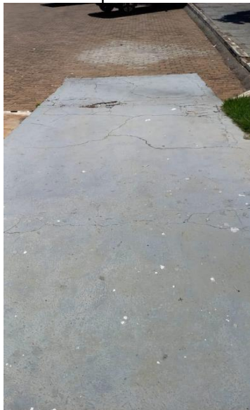
Imagem 01 – Rampa de acesso principal danificada e sem direcionamento tátil.
