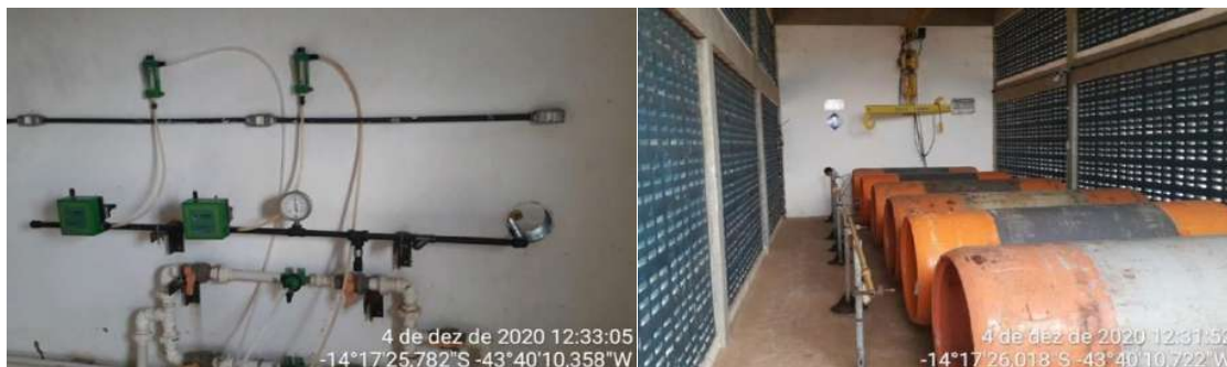
Figura 63 – Registros fotográficos do sistema dosador de cloro e cilindros de armazenamento de cloro
