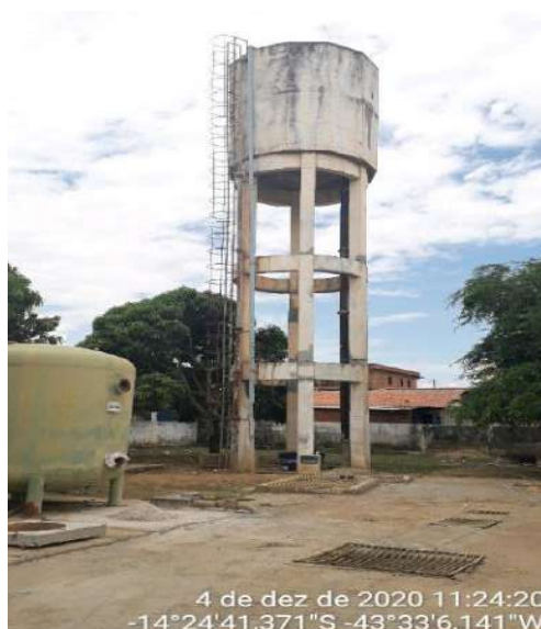
Figura 68 – Registro fotográfico do reservatório que integra o SAA Iuiu
