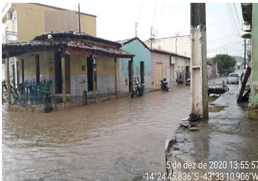
Figura 190 – Avenida Vicente Cristo Lopes com problemas de alagamento
