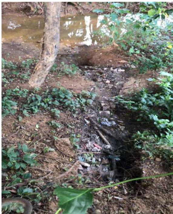
Figura 177 – Lançamento Irregular de esgoto no Riacho da Barragem
