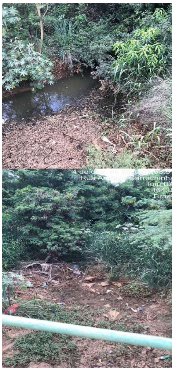
Figura 166 – Córrego sob a ponte na estrada para o distrito de Pindorama com problemas de assoreamento e descarte de resíduos
