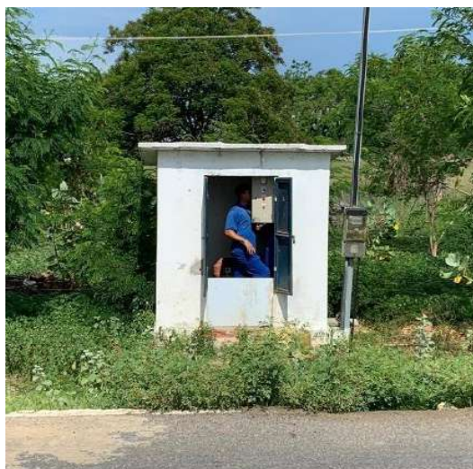
Figura 67 – Registro fotográfico da estação pressurizada (booster)
