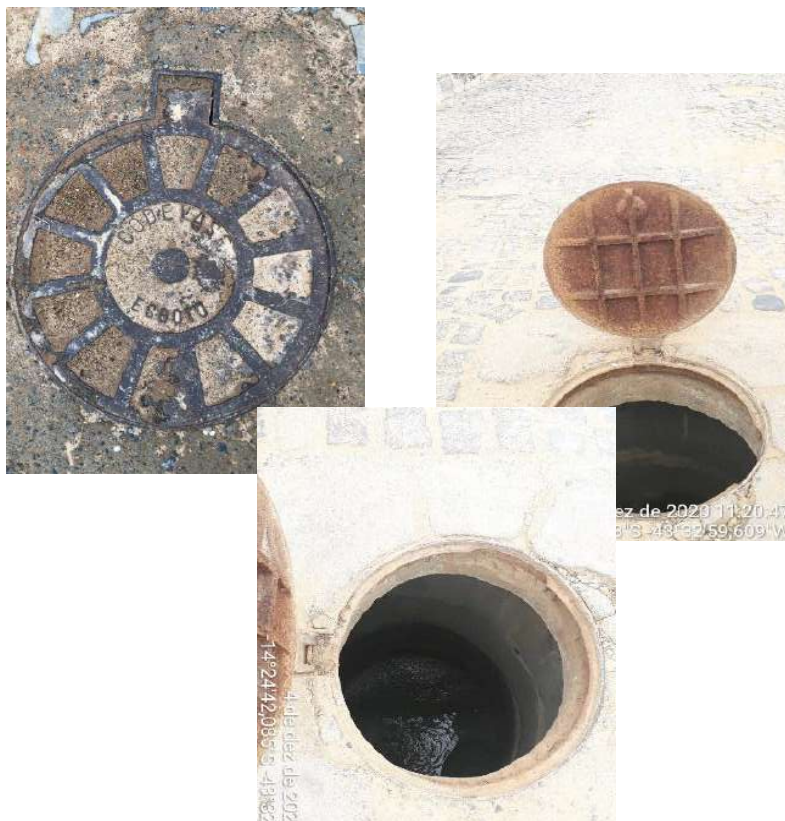
Figura 82 – Registros fotográficos de poço de visita da rede coletora de esgotos do SES Iuiú
