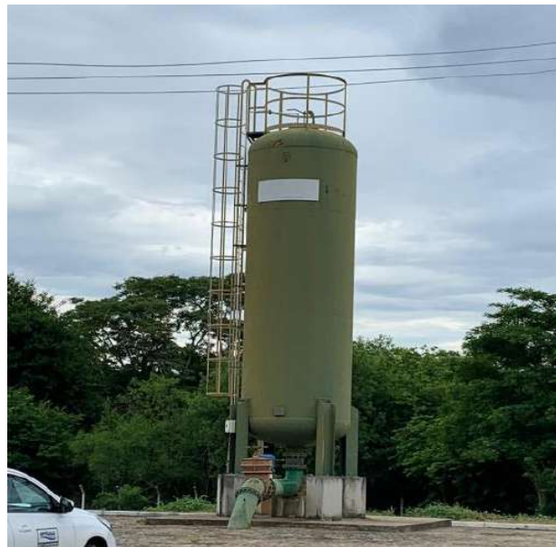
Figura 55 – Registro fotográfico do reservatório utilizado para limpeza do desarenador
