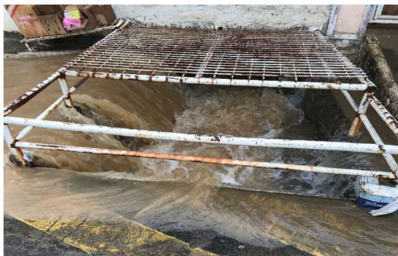
Figura 196 – Caixa Coletora na avenida Vicente Cristo Lopes
