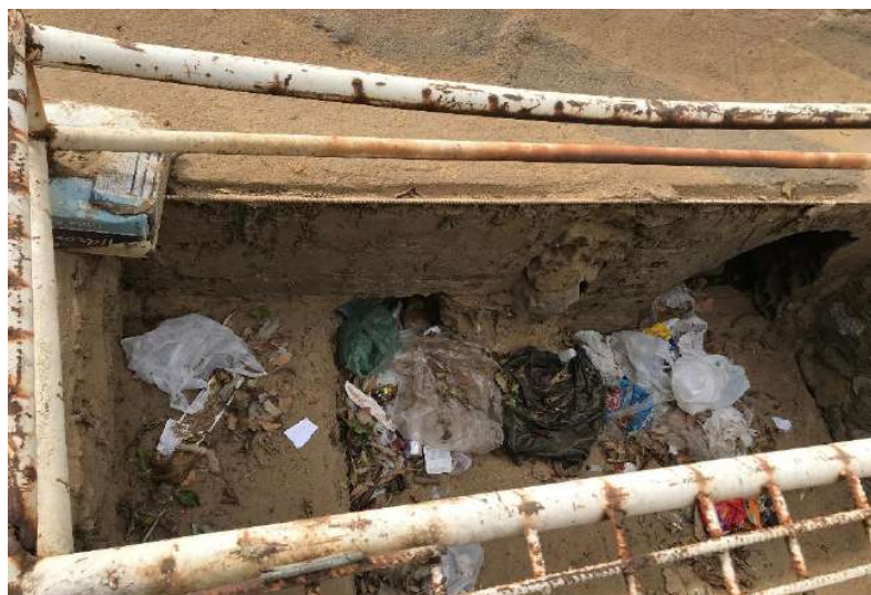
Figura 160 – Resíduos na Caixa Coletora
