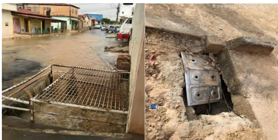
Figura 14 – Estruturas de drenagem que direcionam o fluxo para os canais de drenagem Fonte: Seletiva, 2021.
