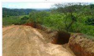
Caixa de contenção de enxurrada
