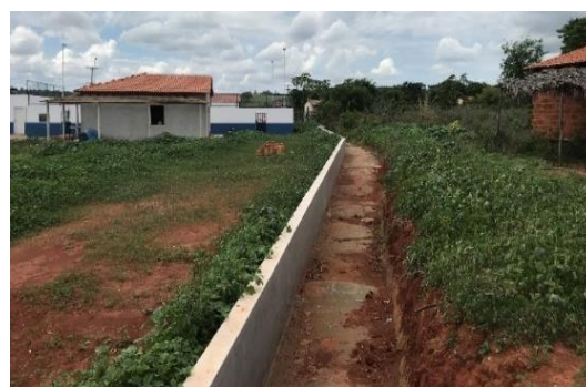
Figura 16 – Vala de infiltração na comunidade de Brejo Bezerra
