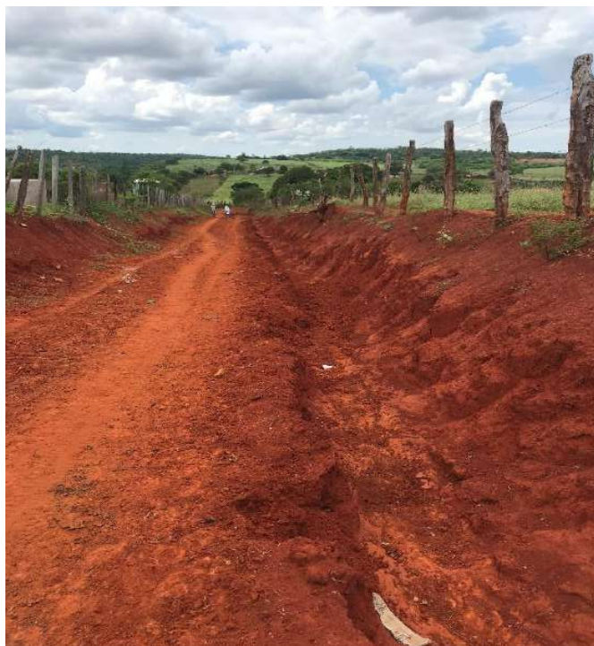
Figura 204 – Erosão nas laterais da estrada vicinal
