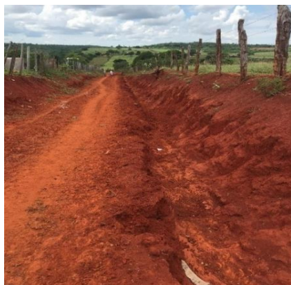
Figura 17 – Erosão nas laterais da estrada vicinal
