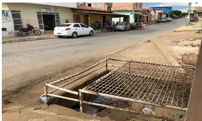
Figura 158 – Caixa coletora com grade no Canal de Drenagem 02
