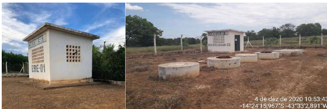
Figura 83 – Registros fotográficos das estações elevatórias de esgotos 01 e 03
