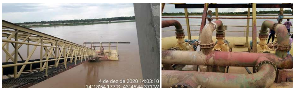
Figura 53 – Registros fotográficos do ponto de captação do SIAA do Algodão
