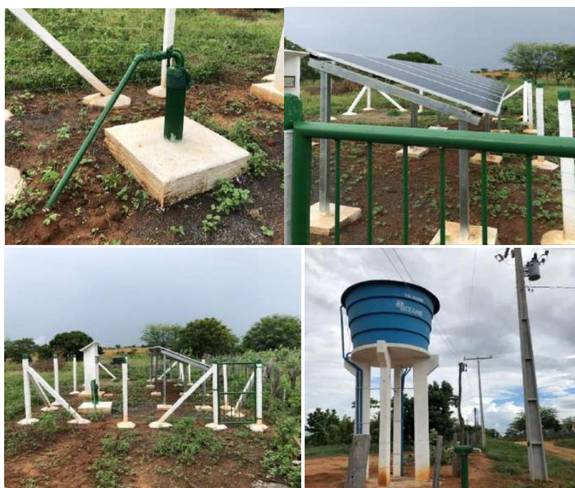
Figura 73 - Registros fotográficos do sistema de abastecimento de Jacolhi
