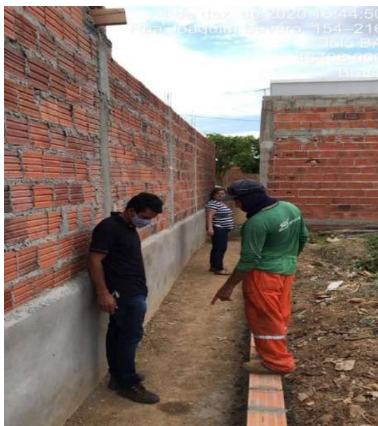
Figura 156 – Trecho do Canal de Drenagem 01 construído pelo morador com seção retangular em concreto
