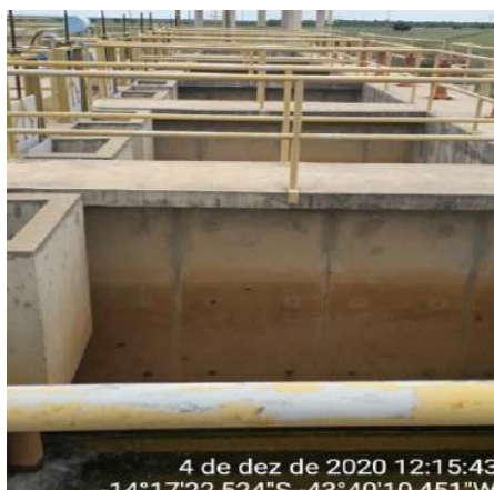
Figura 61 – Registro fotográfico dos filtros
