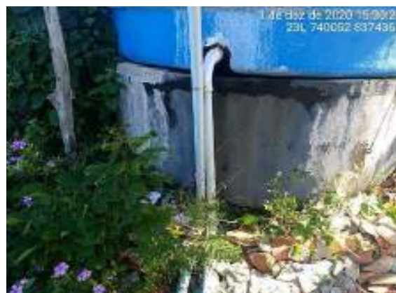
Detalhe da tubulação do reservatório coletivo
