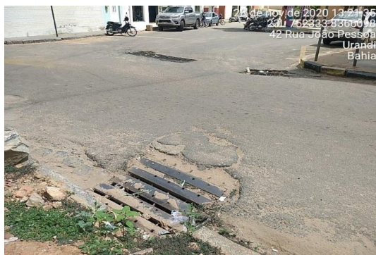
Figura 12 – Bocas de lobo na Rua João Pessoa Fonte: Seletiva, 2021.
