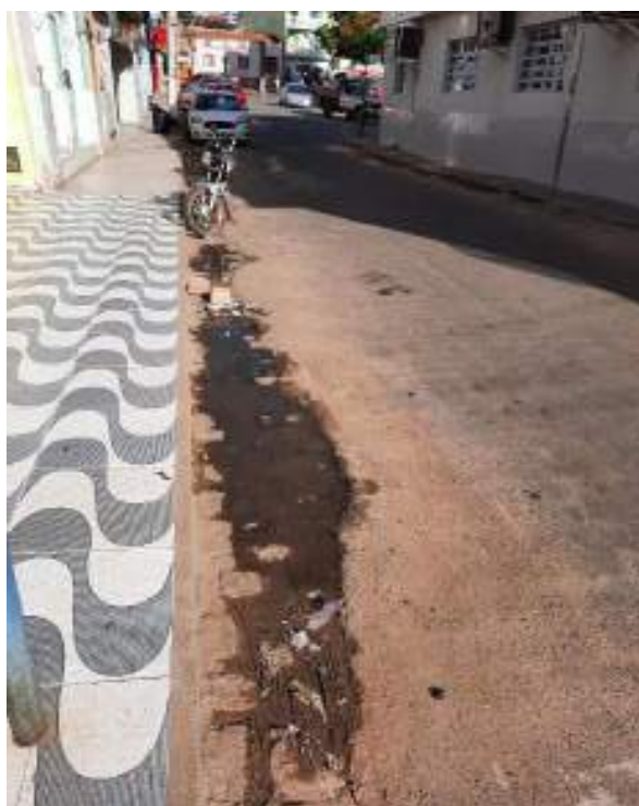
Figura 164 – Lançamento irregular de esgoto em via
