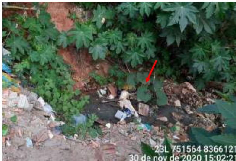
Figura 75 – Registro fotográfico do lançamento de esgoto in natura no solo, à margem da rodovia BR-122, no bairro Xavier
