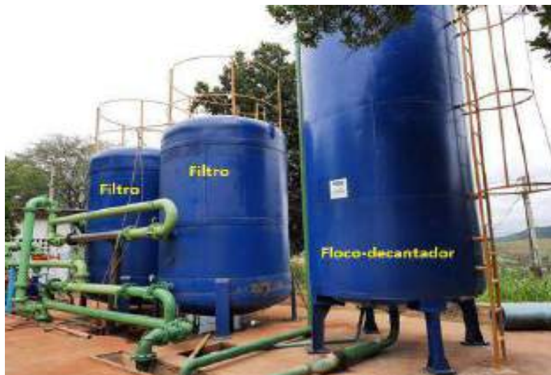
Figura 48 – Registro fotográfico das unidades de tratamento da ETA compacta
