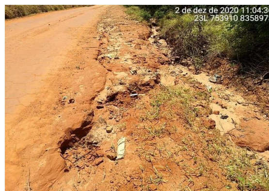
Figura 17 – Erosão identificada na estrada de acesso a comunidade de Salinas
