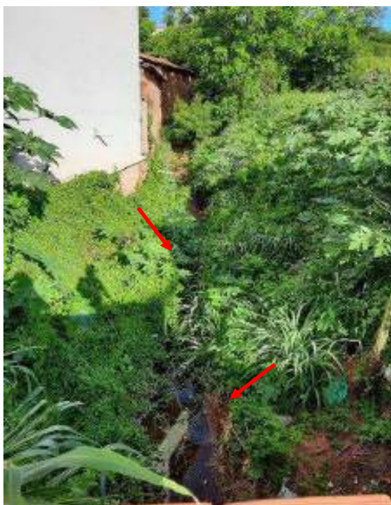
Figura 74 – Registro fotográfico da calha da rede coletora de esgotos, próximo à Avenida Padre Rocha, no bairro DC5
