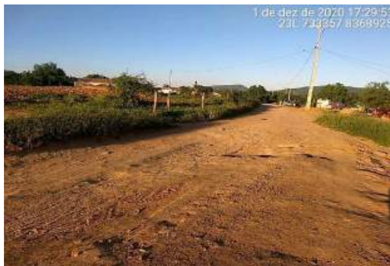
Figura 179 – Ponto de alagamento na avenida principal da comunidade de Lagoa Grande
