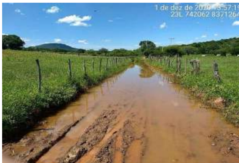
Figura 181 – Ponto crítico na estrada de acesso a comunidade de Cabeçudo
