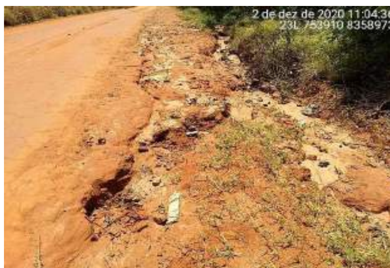
Figura 186 – Erosão identificada na estrada de acesso a comunidade de Salinas
