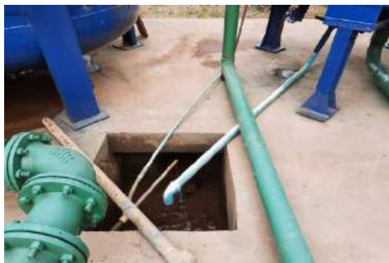
Suspiro do tanque floco-decantador
