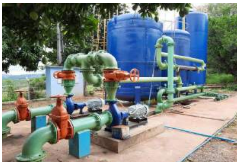
Figura 45 – Registro fotográfico da ETA compacta
