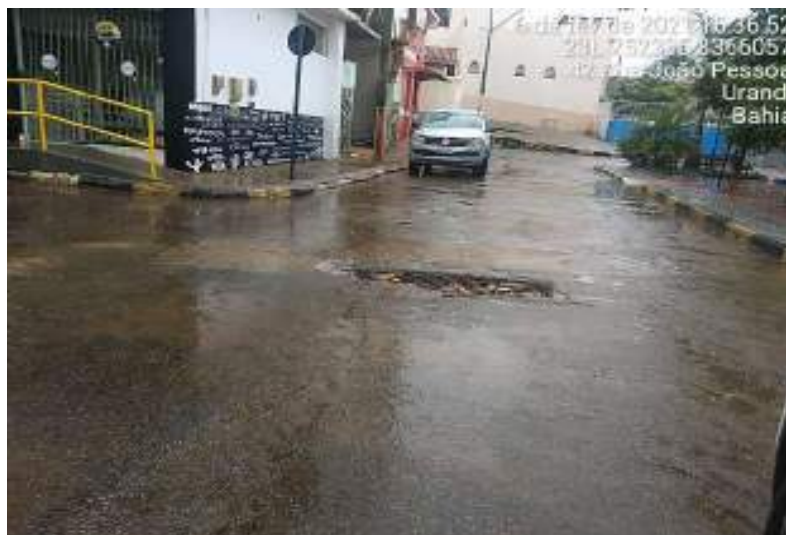
Figura 159 – Bocas de lobo na via que contorna a Praça Ananias de Matos
