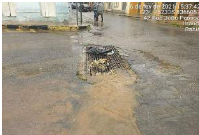
Figura 160 – Boca de lobo na via que contorna a Praça Ananias de Matos
