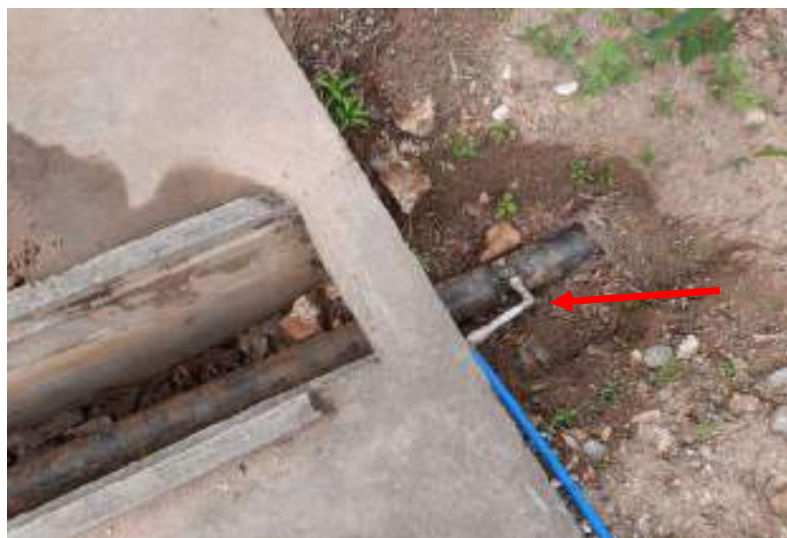
Figura 47 – Registro fotográfico do ponto de adição de sulfato de alumínio na chegada da água bruta da ETA compacta
