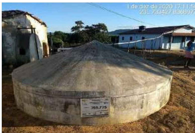
Figura 66 – Registro fotográfico de cisterna de placas na comunidade de Lagoa Grande, para captação de águas de chuva
