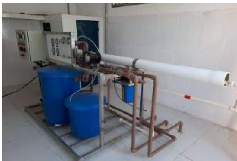
Figura 55 – Registro fotográfico do dessalinizador da solução coletiva implementada por meio do Programa Água Doce na comunidade de Pé da Ladeira
