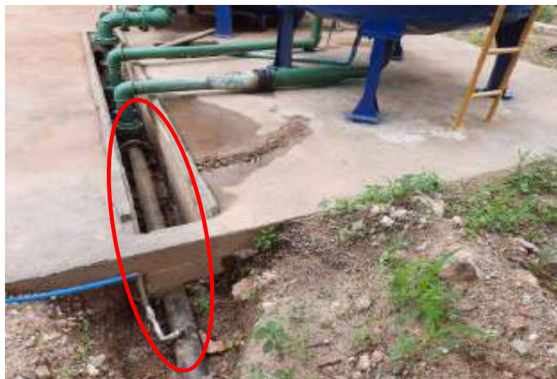
Figura 46 – Registro fotográfico da adutora de água bruta antes da entrada no floco-decantador da ETA compacta
