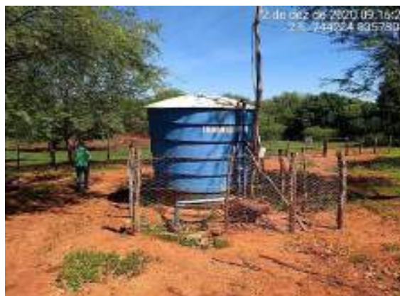
Reservatório coletivo para armazenar água proveniente da adução de água bruta captada no mesmo ponto de captação do SAA da Sede Municipal
