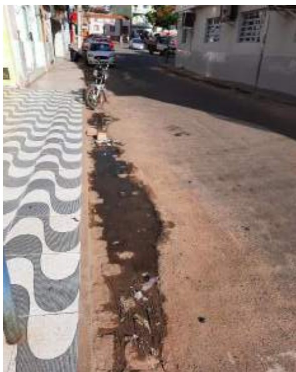
Figura 164 – Lançamento irregular de esgoto em via
