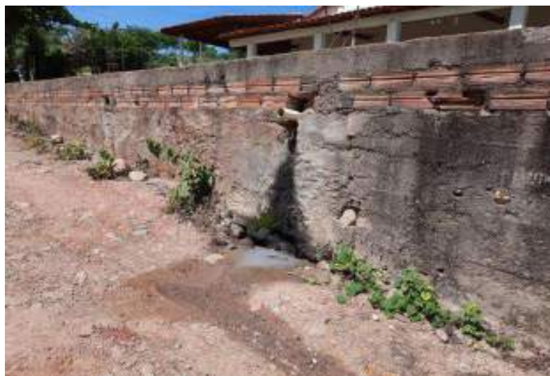
Figura 82 – Registro fotográfico do lançamento de águas cinzas diretamente no solo, na área rural do município de Urandi
