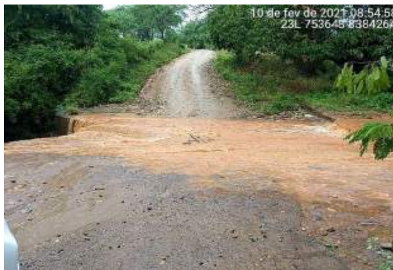
Figura 183 – Ponto crítico na entrada da comunidade de Poções
