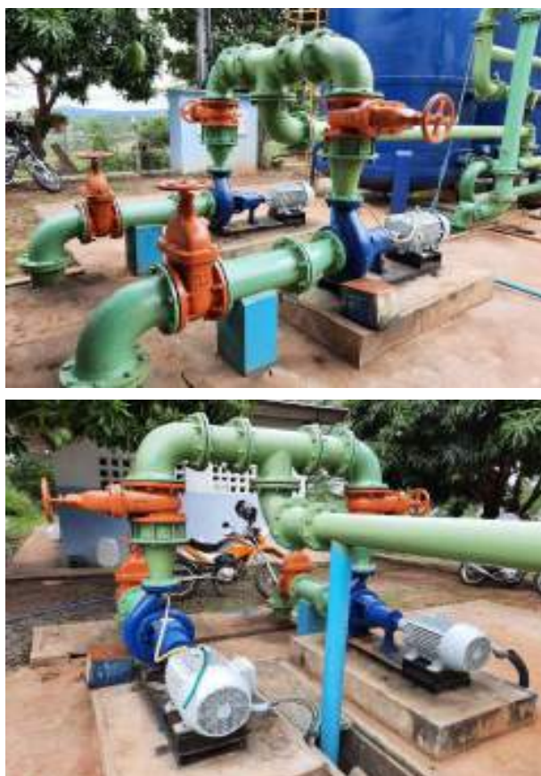
Figura 53 – Registro fotográfico das bombas para elevação da água tratada após etapas do processo de tratamento
