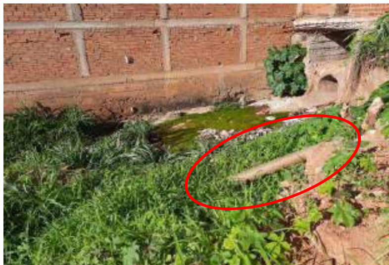
Figura 73 – Registro fotográfico da tubulação da rede coletora de esgotos, possível ser observada em terreno baldio à margem da Av. Padre Rocha
