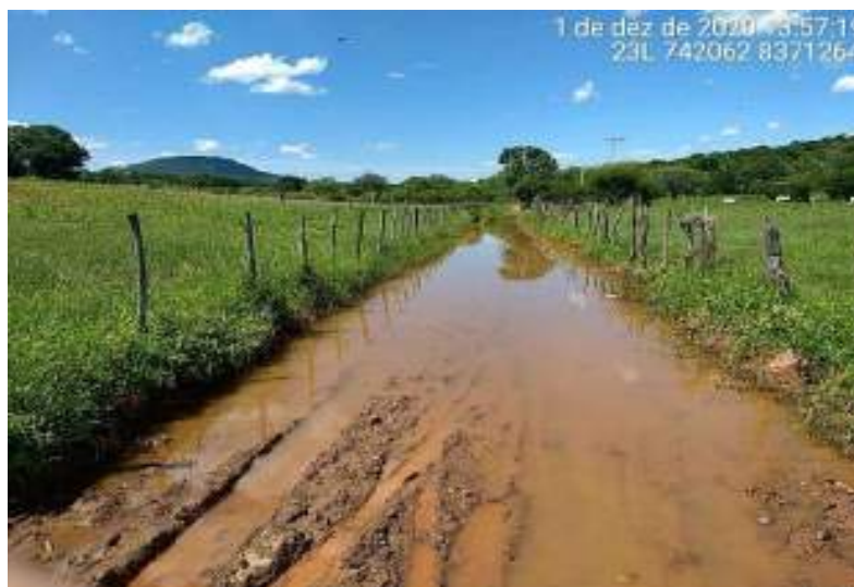
Figura 181 – Ponto crítico na estrada de acesso a comunidade de Cabeçudo
