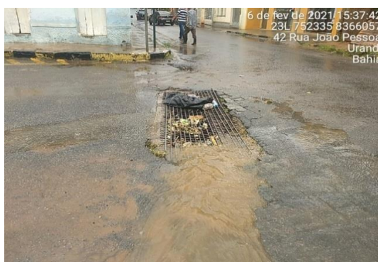
Figura 13 – Bocas de lobo nas vias que contornam a Praça Ananias de Matos Fonte: Seletiva, 2021.
