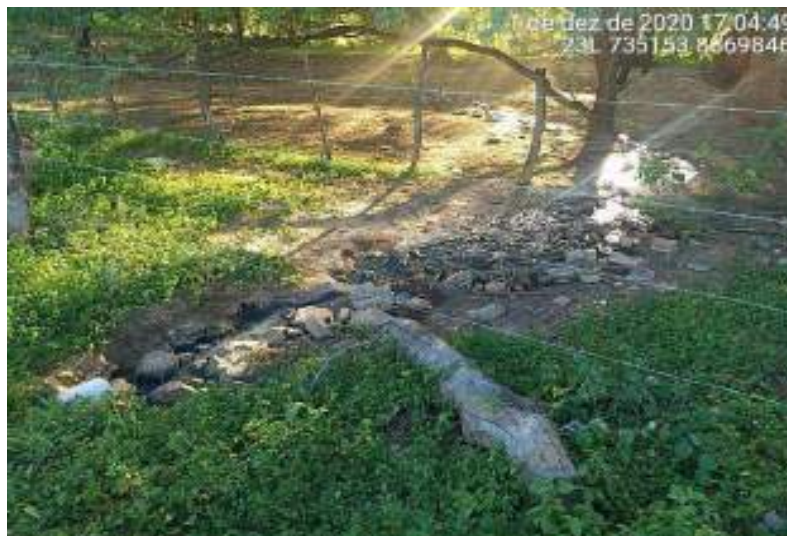
Figura 79 – Registro fotográfico de ponto de lançamento de esgotos in natura , no povoado rural de Cantinho
