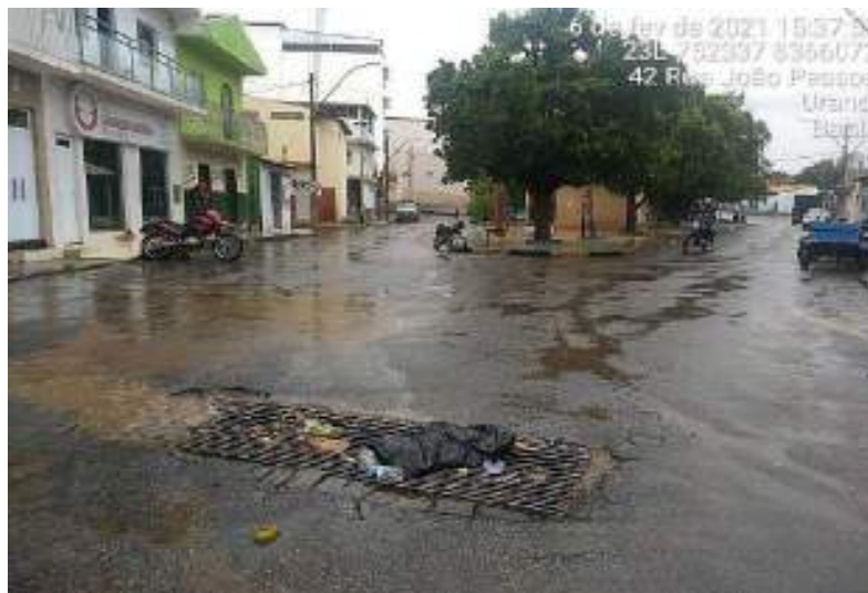
Figura 112 – Resíduos carreados pela chuva a rede de coleta das águas pluviais e esgotos
