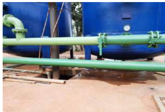
Vazamento de água em um dos filtros da ETA compacta
