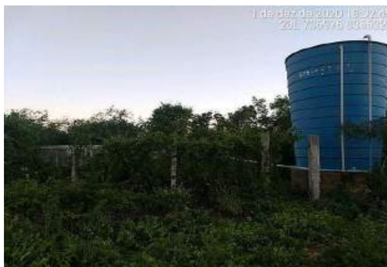
Figura 63 – Registro fotográfico do reservatório coletivo para abastecimento das comunidades de Cantinho e Lagoa Grande
