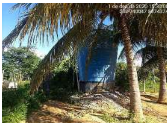
Reservatório coletivo para armazenar água proveniente do poço artesiano
