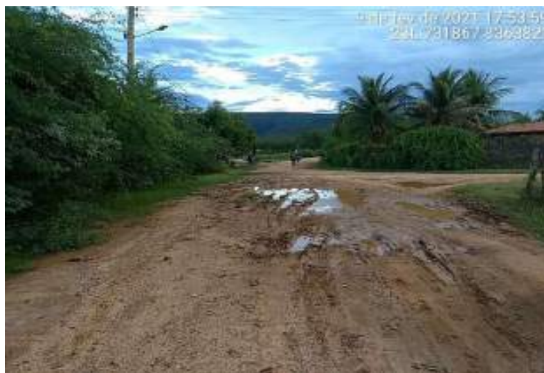
Figura 184 – Ponto crítico na comunidade de Núcleo II
