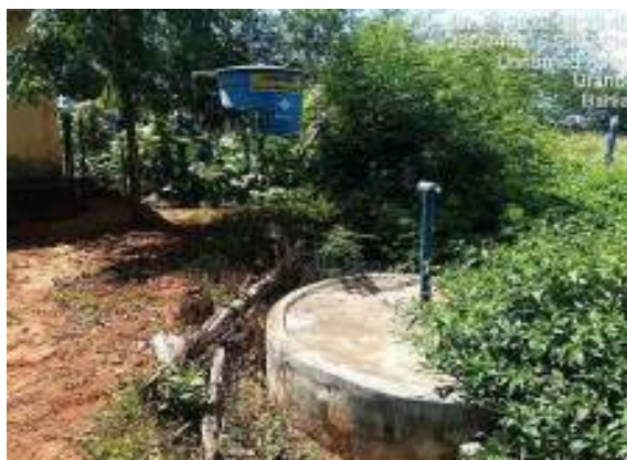
Reservatório coletivo para armazenar água proveniente do poço artesiano e chafariz comunitário
