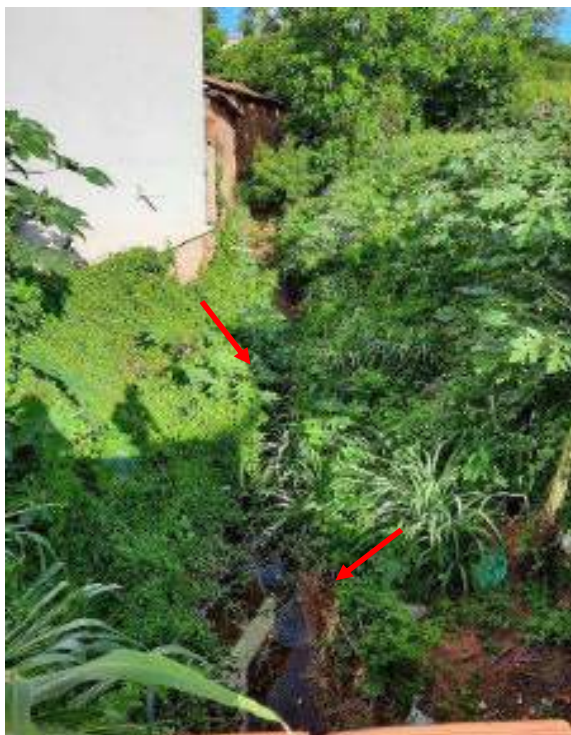
Figura 74 – Registro fotográfico da calha da rede coletora de esgotos, próximo à Avenida Padre Rocha, no bairro DC5
