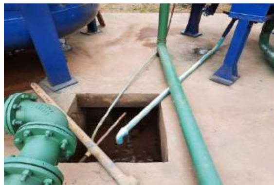
Suspiro do tanque floco-decantador
