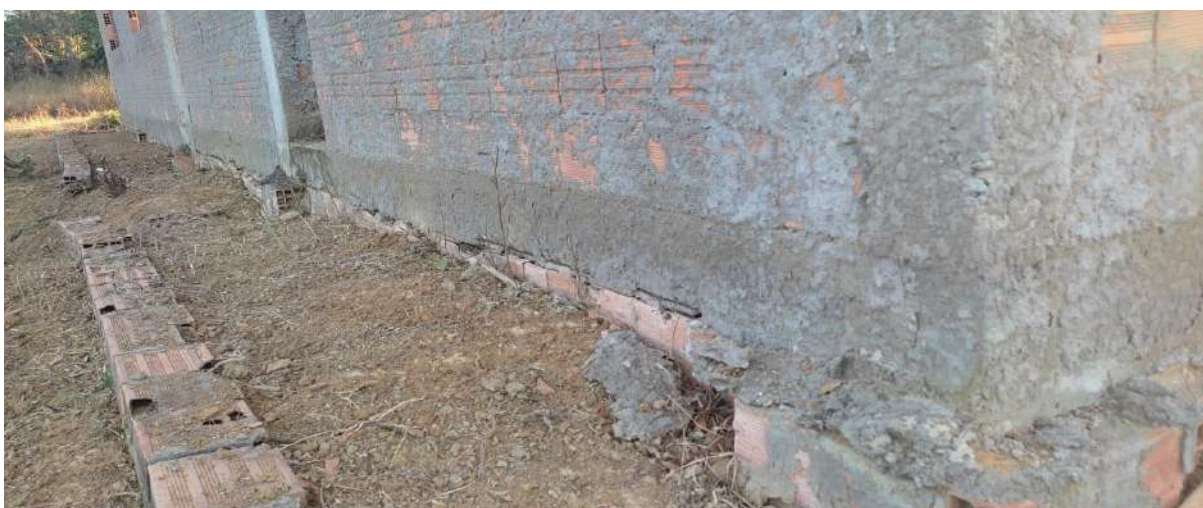
Figura 13 – 1- Baldrame com falha na concretagem e ferragem exposta e oxidada. Fonte: elaboração própria
