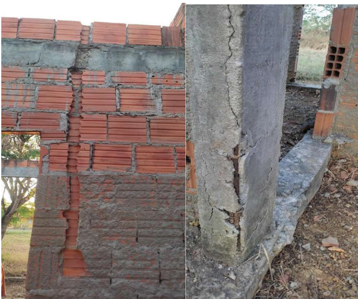
Figura 30 – 1- Verga não executada. 2- Viga perfurada para passagem de tubulação. 3- Pilar com armação exposta oxidada, trincas. Fonte: elaboração própria
