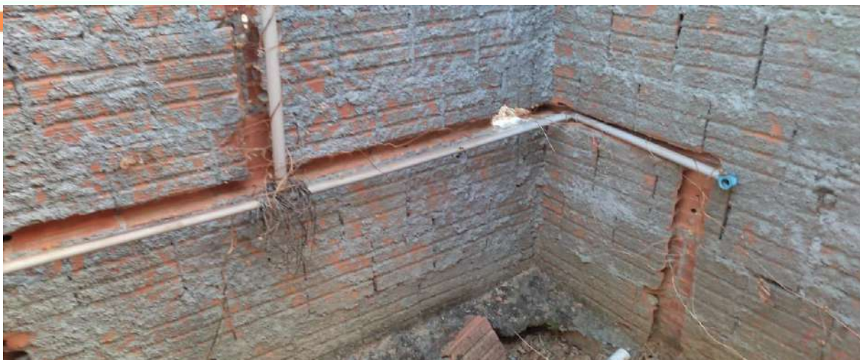
Figura 31 – 1- Passagem de tubulação em tamanho inferior ao de projeto. Fonte: elaboração própria
