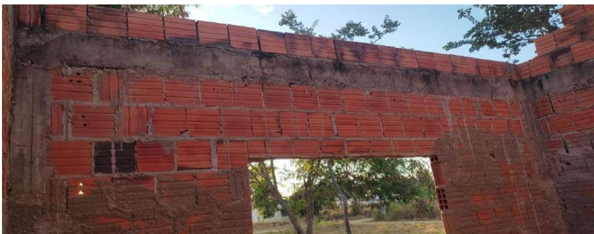
Figura 22 –1- Verga não executada. 2- Presença de pano da alvenaria. Fonte: elaboração própria
