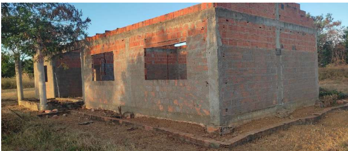
Figura 15 – 1- Perfuração de viga baldrame para passagem de tubulação. 2- Baldrame não impermeabilizada. 3- Execução de alvenaria. 4- Vergas e contra vergas suprimidas. Fonte: elaboração própria
