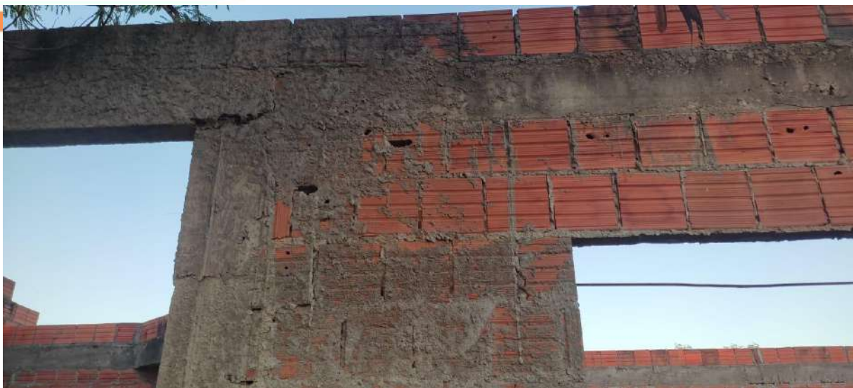
Figura 33 – 1- Verga não executada. 2- Presença de pano da alvenaria rebocada. Fonte: elaboração própria
