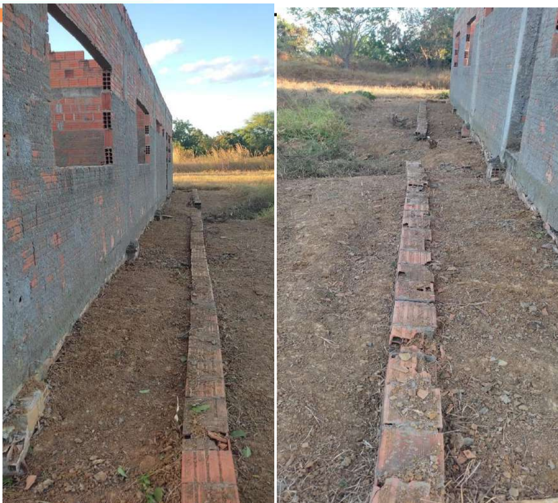
Figura 11 – 1- Execução de chapisco. 2- Vergas e contravergas não executadas. 3- Desnível não aterrado. Fonte: elaboração própria
