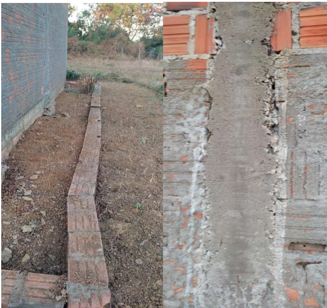
Figura 32 – 1- Alvenaria de embasamento desnivelada. 2- Pilar concretado utilizando alvenaria como forma, com broca, bicheira e armação exposta. Fonte: elaboração própria
