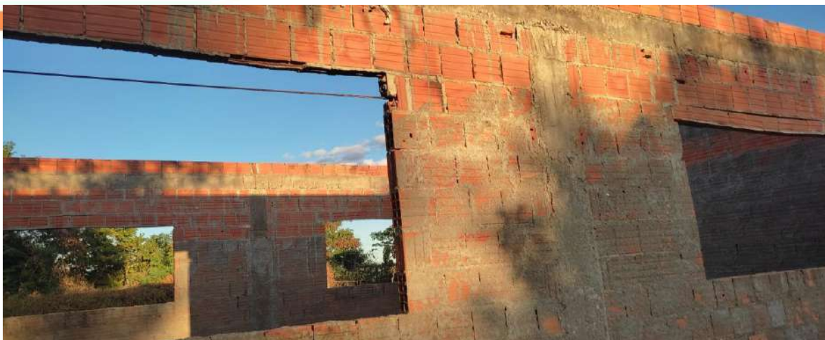
Figura 6 – 1- Pilares moldados na alvenaria. 2- Vergas e contravergas suprimidas. Fonte: elaboração própria
