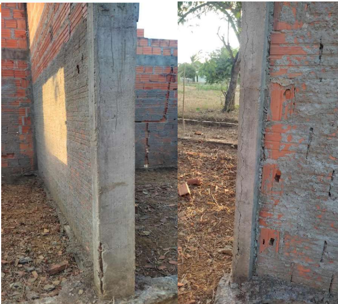
Figura 19 – 1- Baldrame não impermeabilizado. 2- Pilar concretado utilizando alvenaria com forma, com junta fria, brocas, bicheiras e armação oxidada exposta. 3- Fissura e trinca. Fonte: elaboração própria
