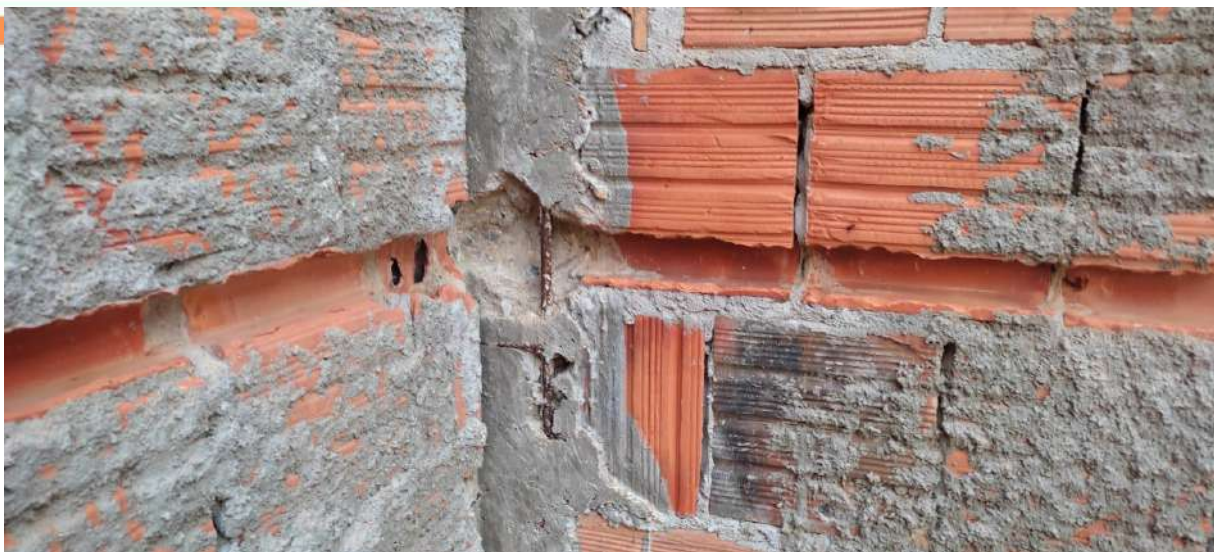
Figura 17 – PÁTIO COBERTO 1- Presença de vegetação. 2- Presença de pano da alvenaria rebocada. 3- Acúmulo de lixo Fonte: elaboração própria
