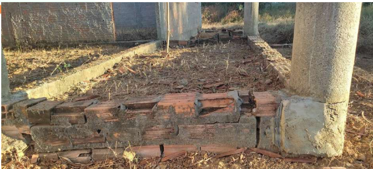
Figura 25 – 1- Alvenaria de embasamento quebrada. Fonte: elaboração própria
