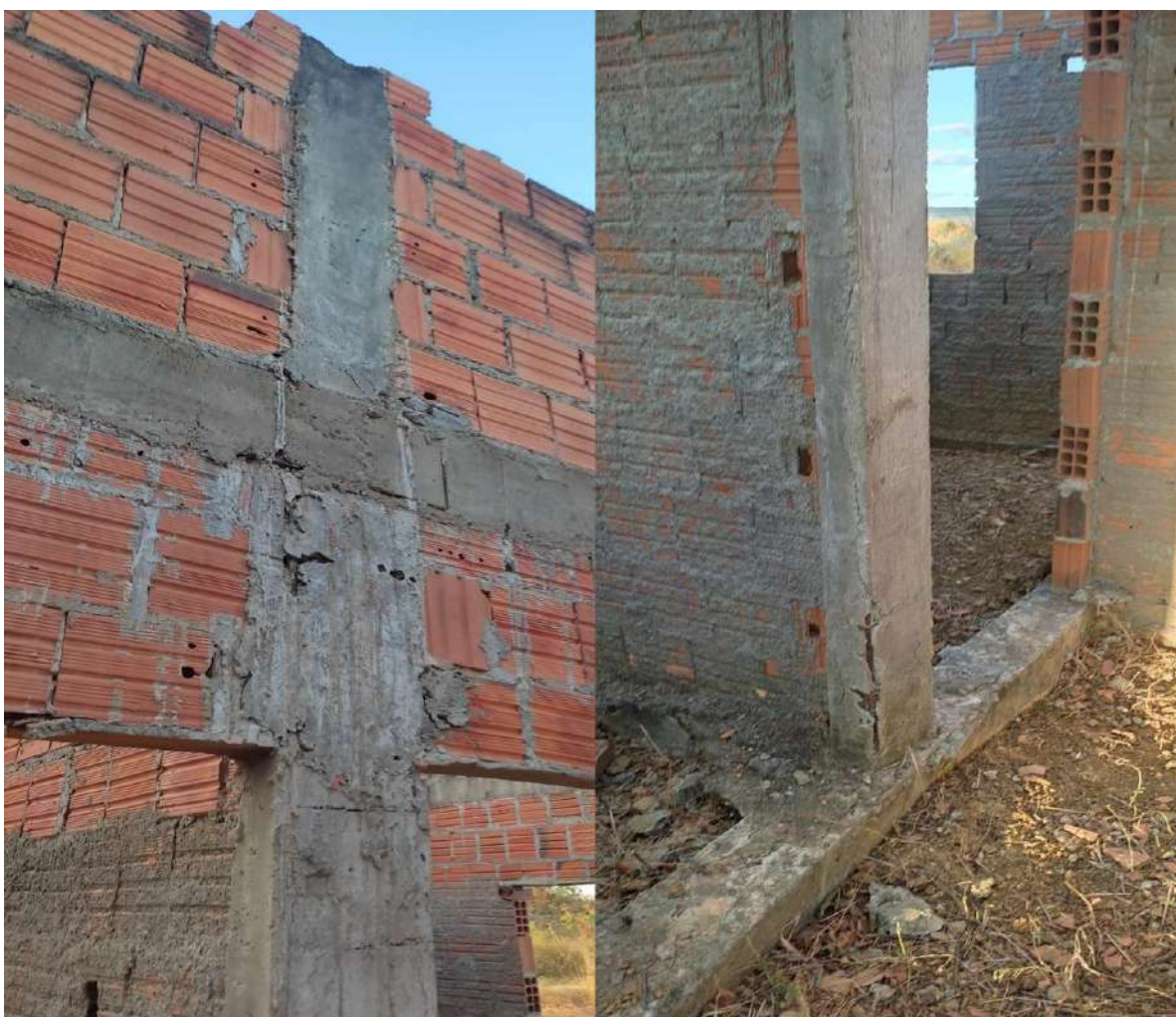
Figura 18–1- Baldrame não impermeabilizado. 2- Pilar concretado utilizando alvenaria com forma, com junta fria, brocas, bicheiras e armação oxidada exposta. 3- Fissura. Fonte: elaboração própria
