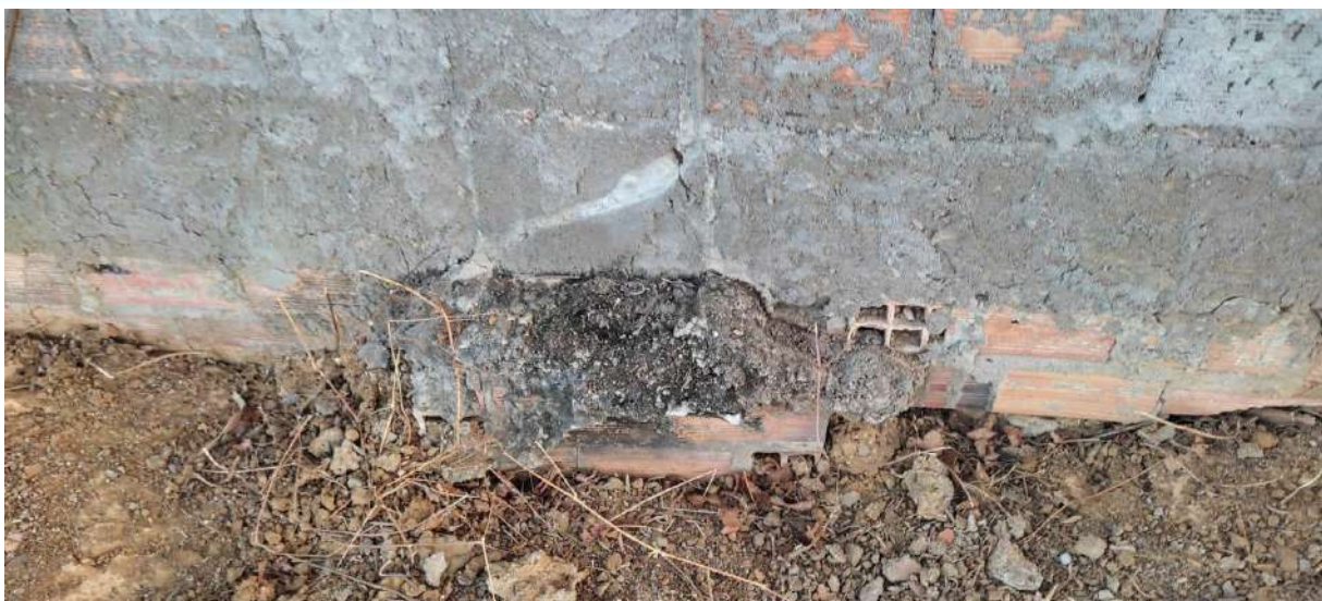
Figura 27 – 1- Alvenaria de embasamento. 2- Baldrame não impermeabilizado. Fonte: elaboração própria
