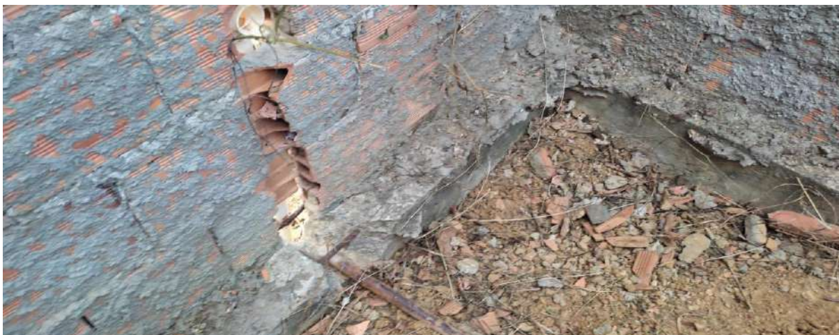
Figura 21 –1- Baldrame não impermeabilizado. 2- Perfuração de baldrame para passagem de tubulação Fonte: elaboração própria
