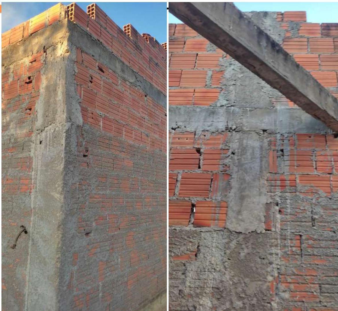
Figura 9 – 1- Utilização de alvenaria como forma para pilares com redução de seção. 2- Concretagem em duas etapas com junta fria. 3- Brocas e bicheira. Fonte: elaboração própria
