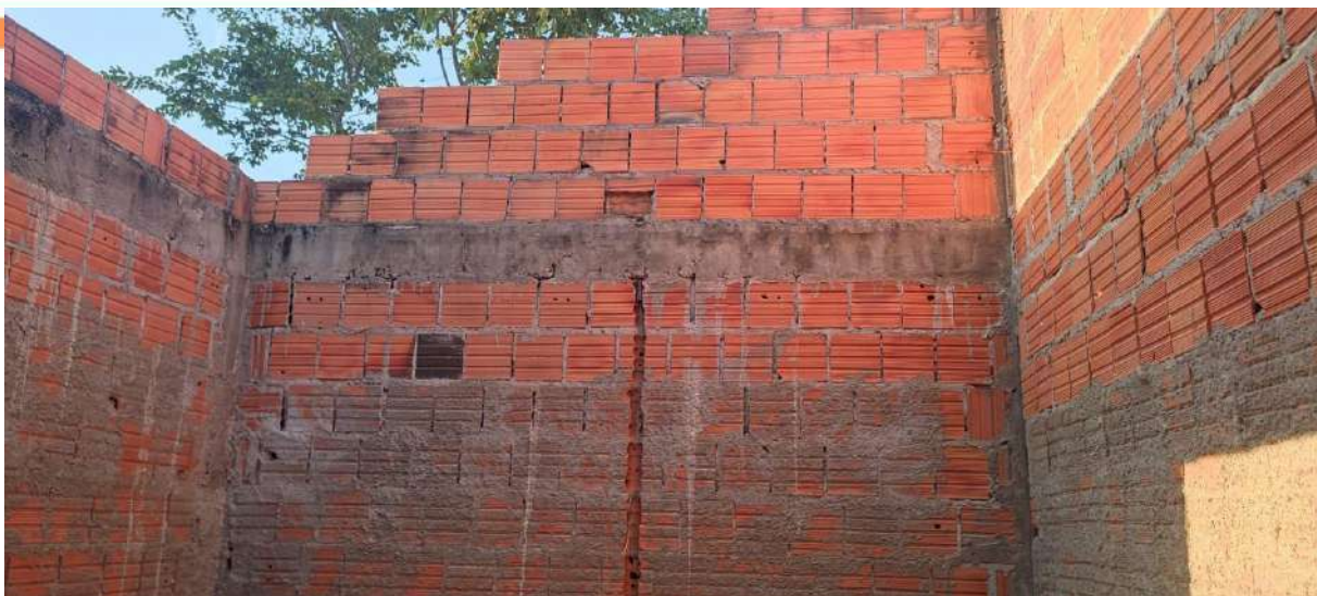
Figura 23 – 1- Presença de pano da alvenaria. Fonte: elaboração própria
