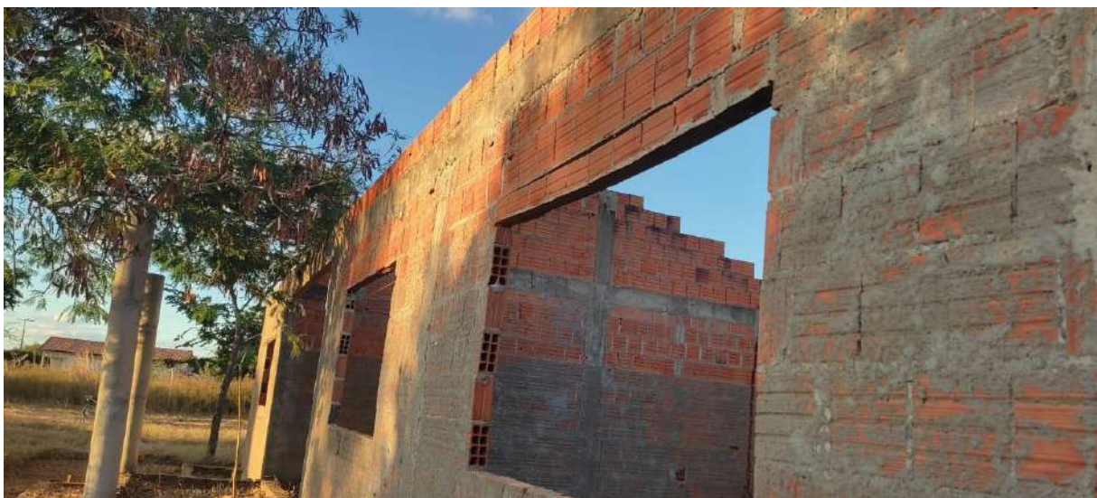
Figura 10 – 1- Vergas e contravergas suprimidas. Fonte: elaboração própria
