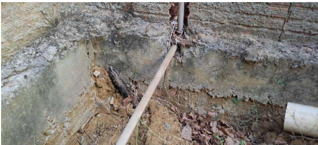
Figura 16 –1- Baldrame perfurado para passagem de tubulação. Fonte: elaboração própria
