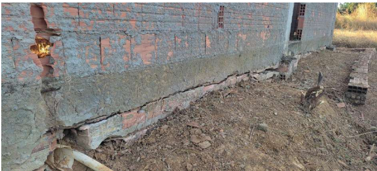
Figura 12 – 1- Baldrame com falha na concretagem e ferragem exposta e oxidada. Fonte: elaboração própria
