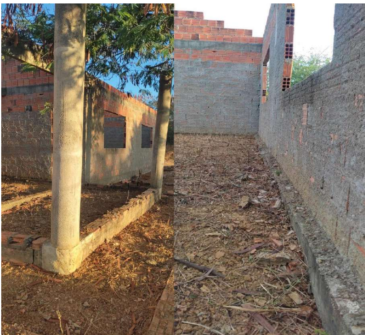
Figura 26 – 1- Contravergas não executada. 2- Presença de lixo e vegetação rasteira. Fonte: elaboração própria
