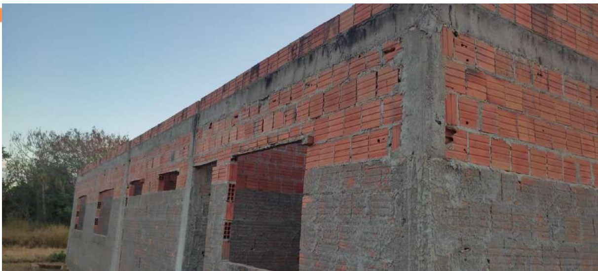
Figura 35 –1- Presença de pano da alvenaria. 2- Vergas e contravergas não executadas. Fonte: elaboração própria
