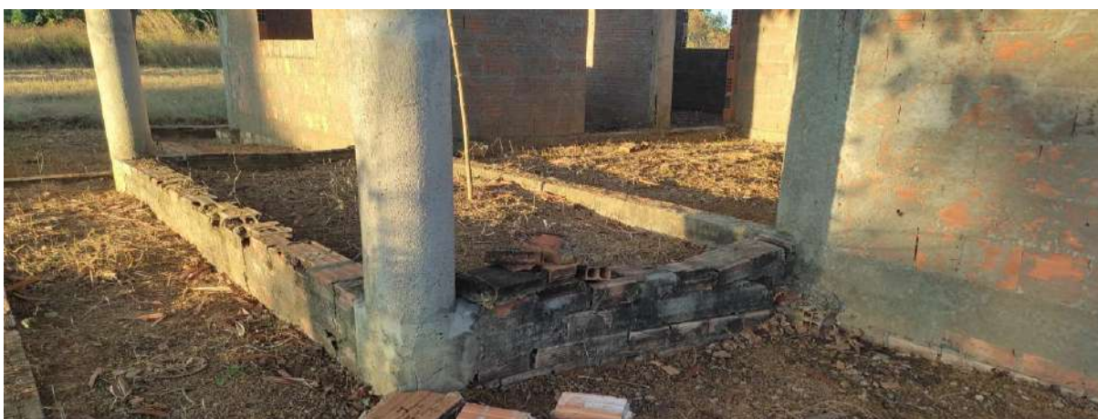
Figura 7 – 1- Baldrame não impermeabilizado. 2- Execução de base em alvenaria. Fonte: elaboração própria
