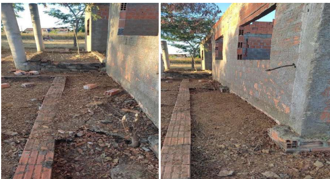
Figura 8 – 1- Utilização de alvenaria como forma para fundação. 2- Acúmulo de lixo. Fonte: elaboração própria
