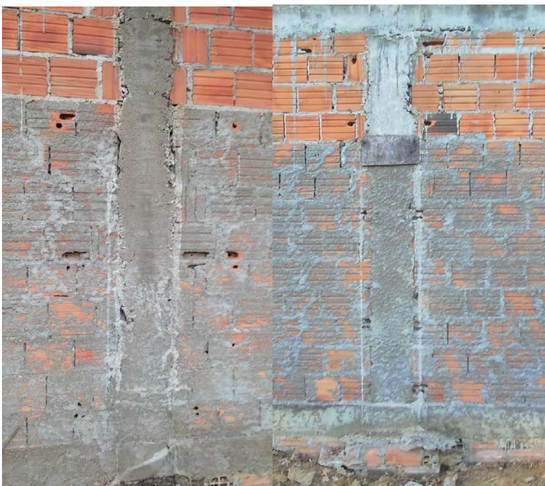
Figura 34 – 1- Pilar concretado utilizando alvenaria como forma, com broca, bicheira e armação exposta. Fonte: elaboração própria
