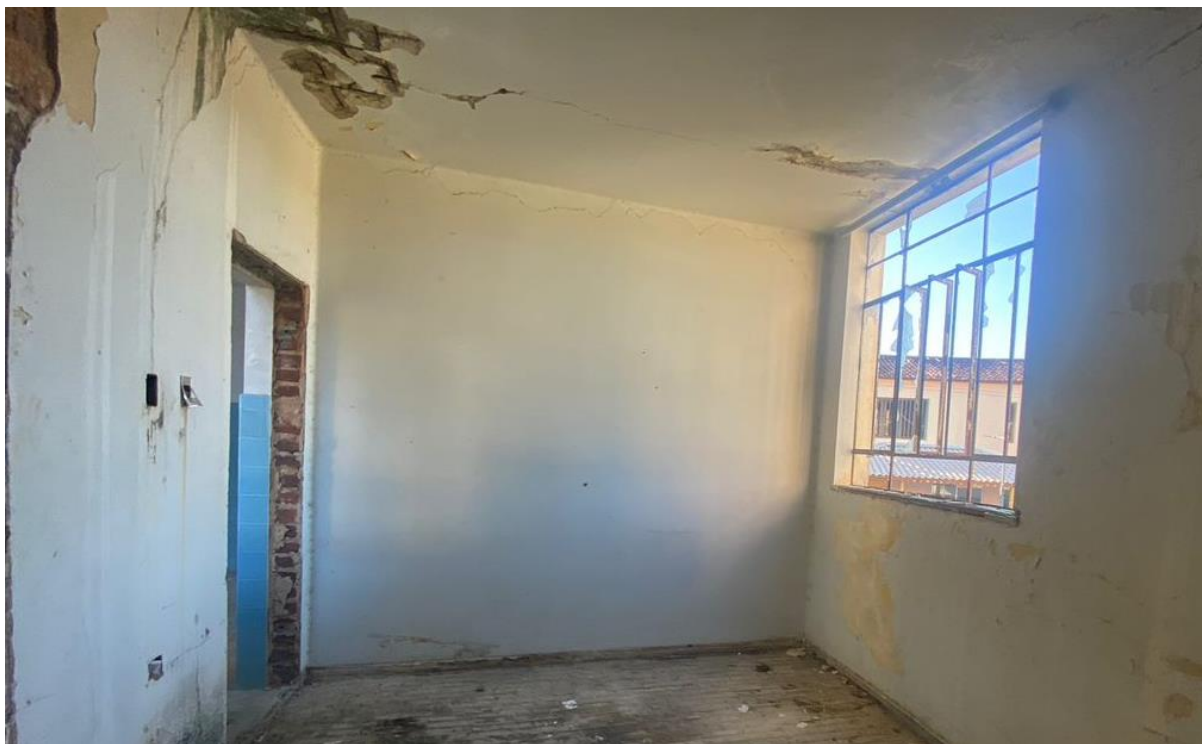
Figura 05. Imagem de uma sala do prédio da Coordenadoria Municipal de Educação, Itambé-BA.
