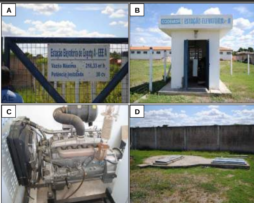
Figura 6.79 – Estação elevatória de esgoto - EEE 01.
