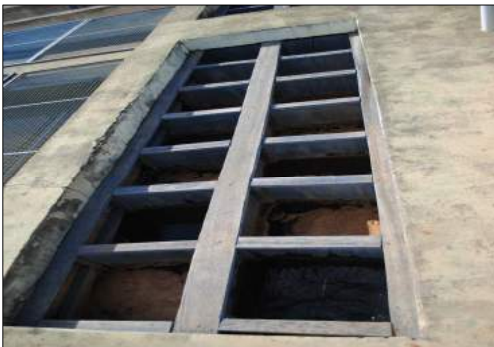
Figura 6.15 – Flocculadores da ETA. Fonte: DRZ Geotecnologia e Consultoria (2015).
