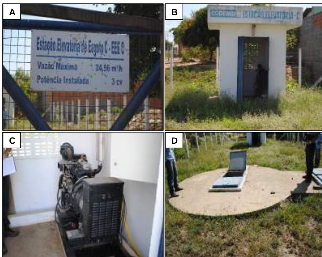
Figura 6.81 – Estação Elevatória de Esgoto - EEE 03.
