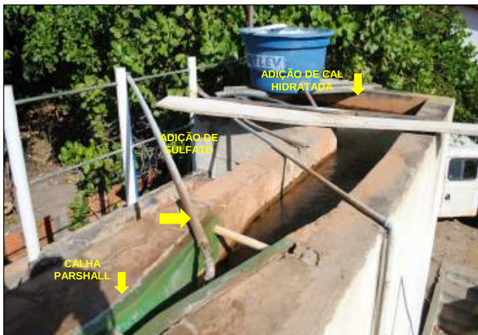
Figura 6.12 – Calha parshall e adição das soluções.
