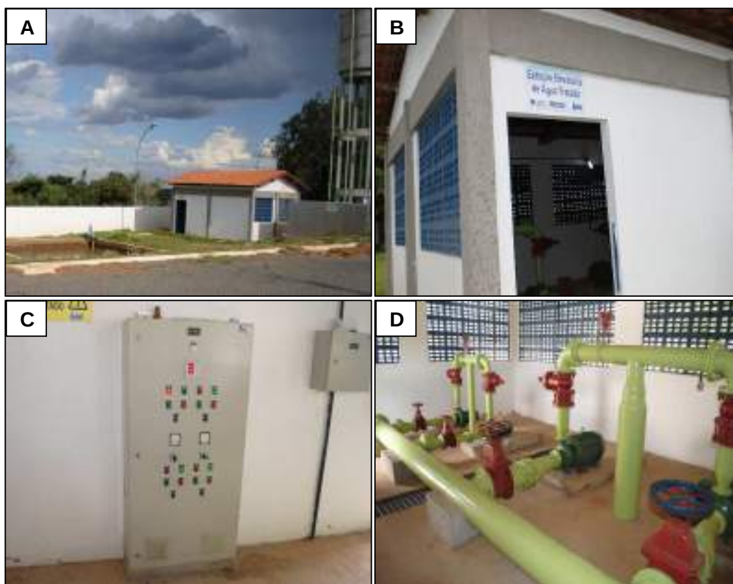
Figura 6.71 – Estação elevatória de água tratada.
