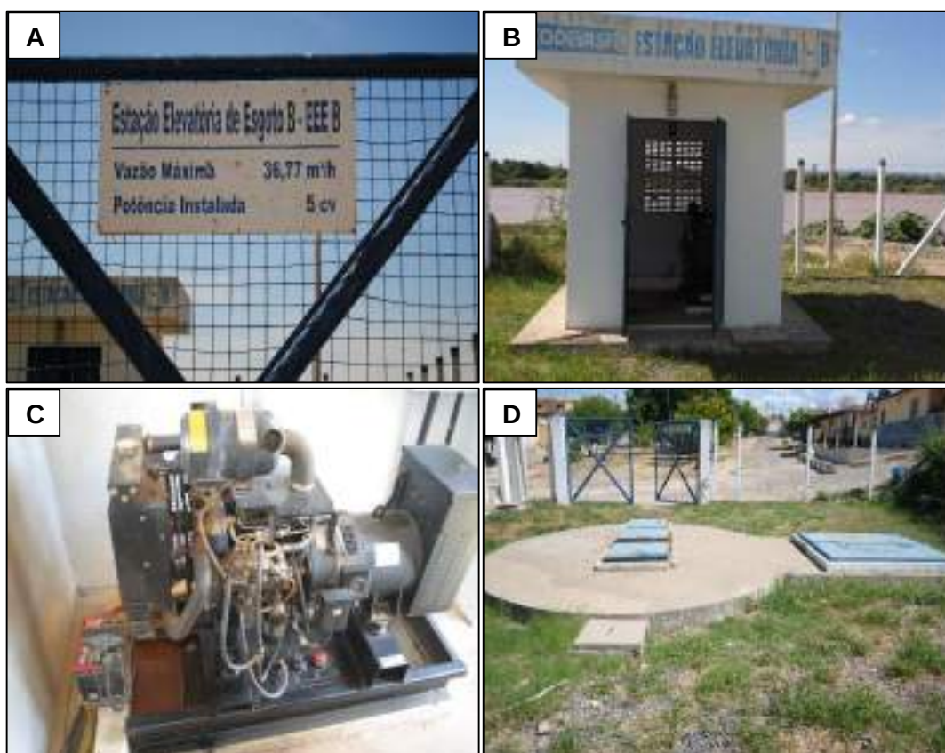
Figura 6.80 – Estação elevatória de esgoto - EEE 02.
