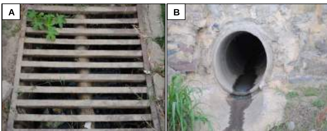
Figura 6.150 – Lançamento de esgoto na rede de drenagem.
