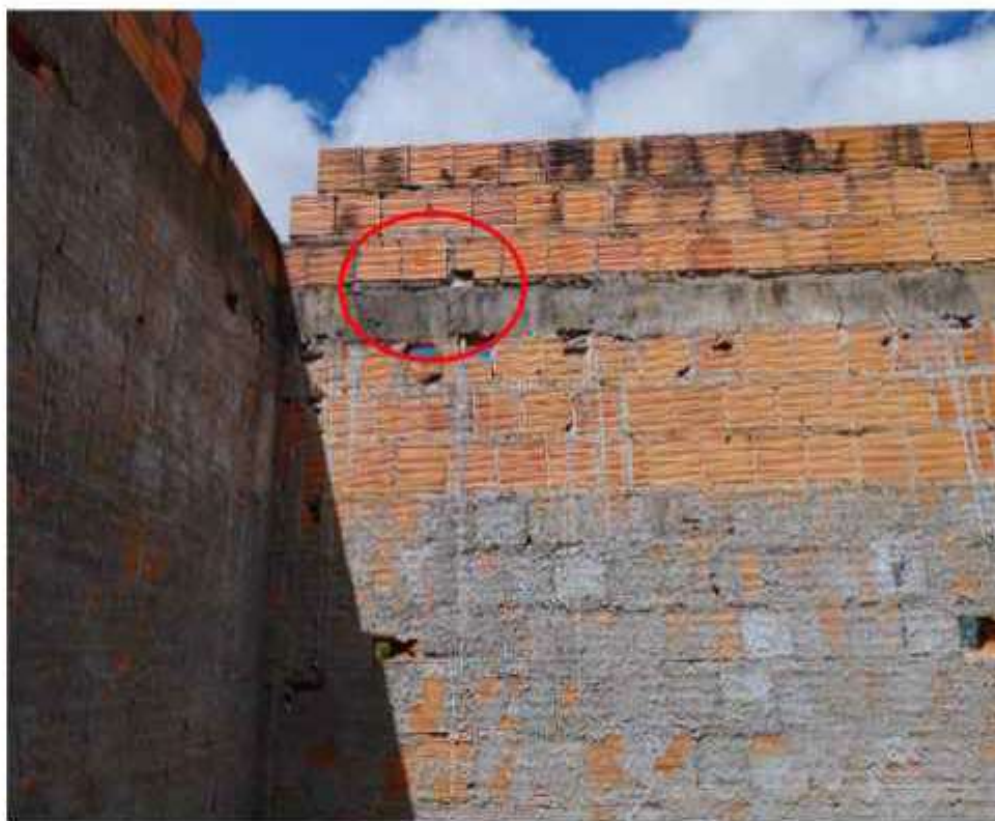
Figura 14 – Ferragens expostas, quebra de seções da viga com tubulações
