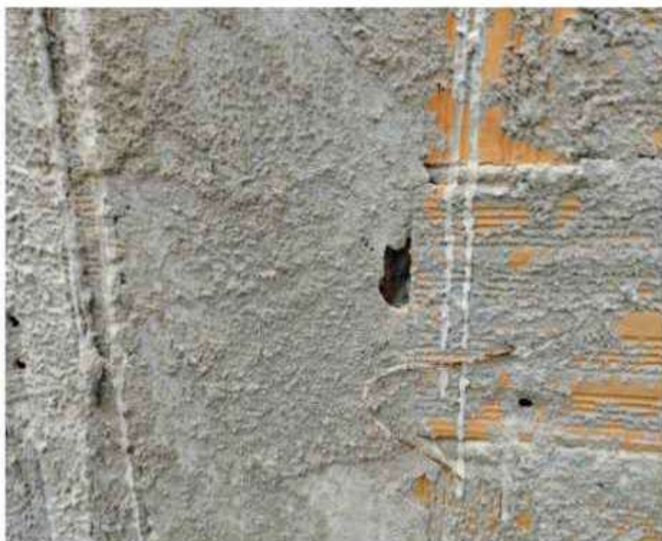
Figura 18 – Pilar com falha de concretagem
