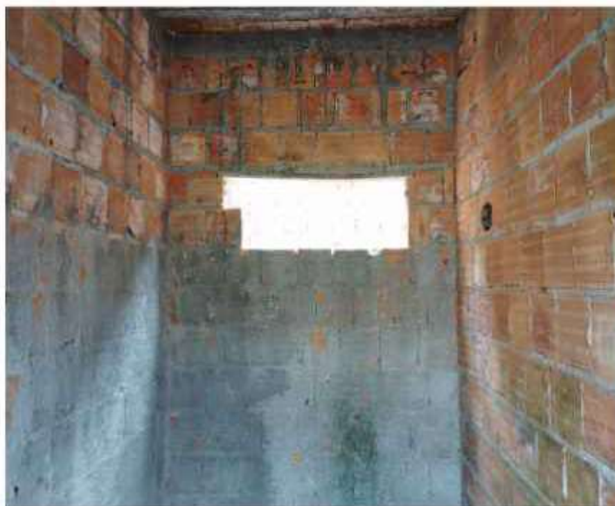
Figura 12 – Vista atual do lote – Vergas executada, porém em desconformidade com a NBR
