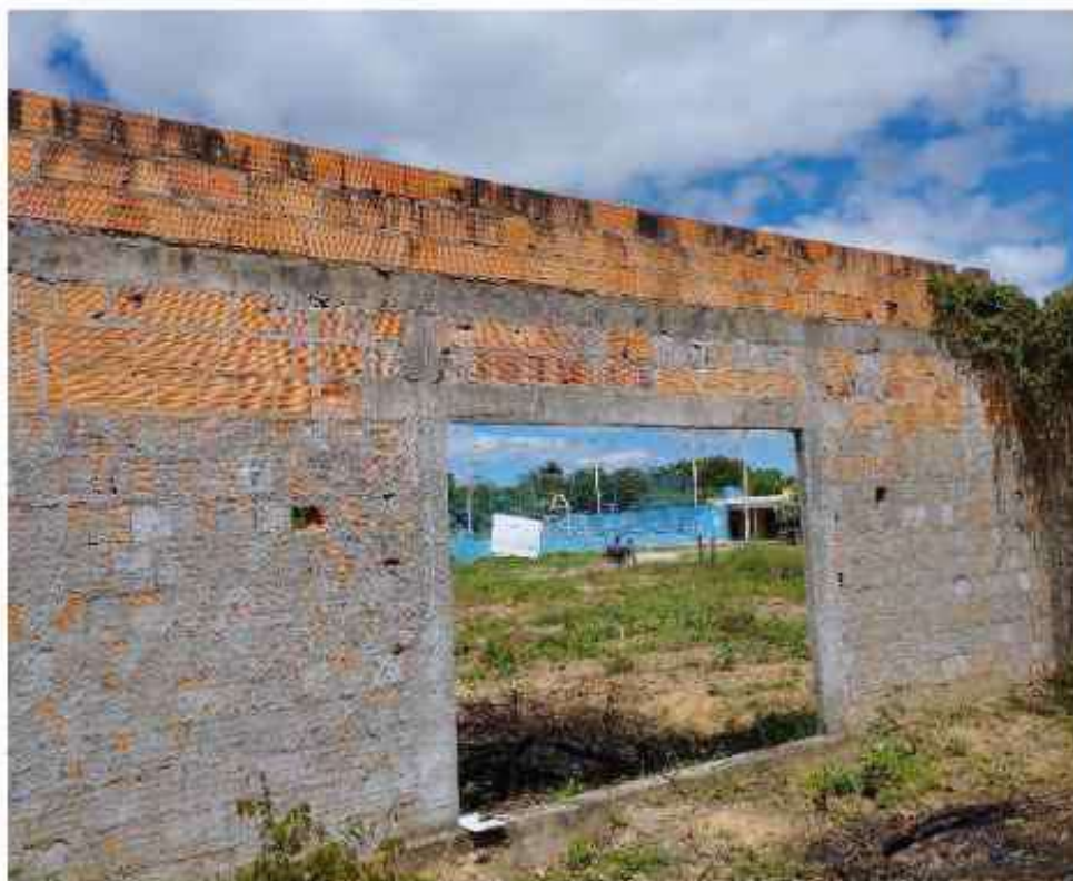
Figura 13 – Vista atual do lote – Viga baldrame não aterrada – desníveis internos
