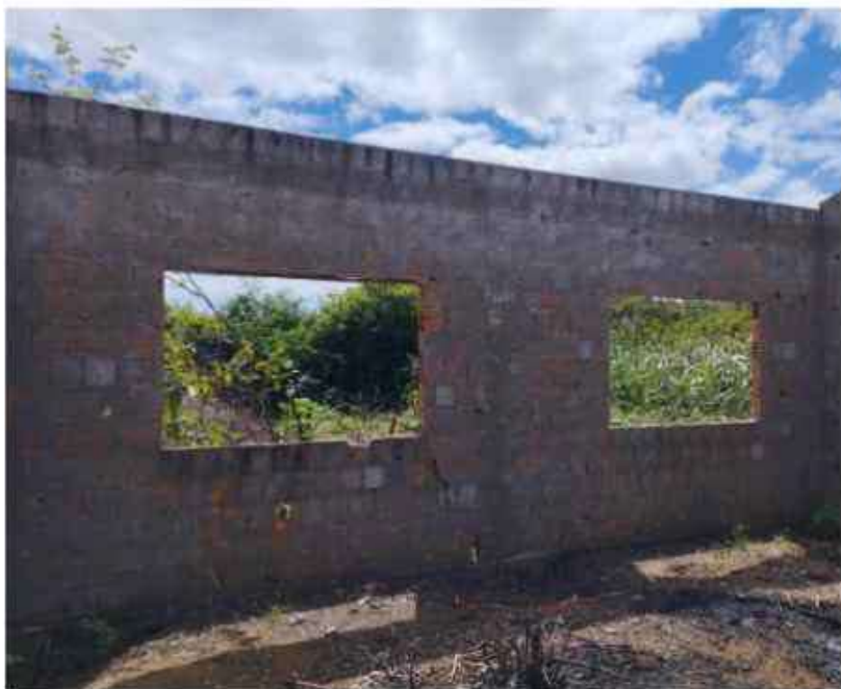
Figura 15 – Vergas e Contravergas não executadas
