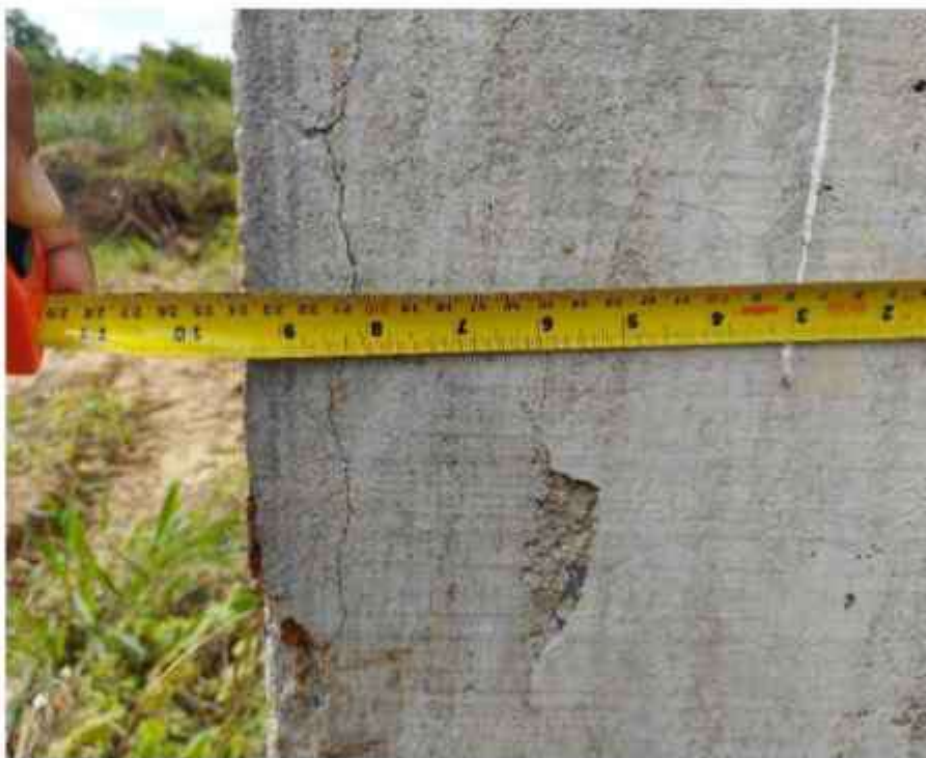
Figura 25 – Fissuras aparentes no concreto do pilar Fonte: elaboração própria. (20/05/2024)
